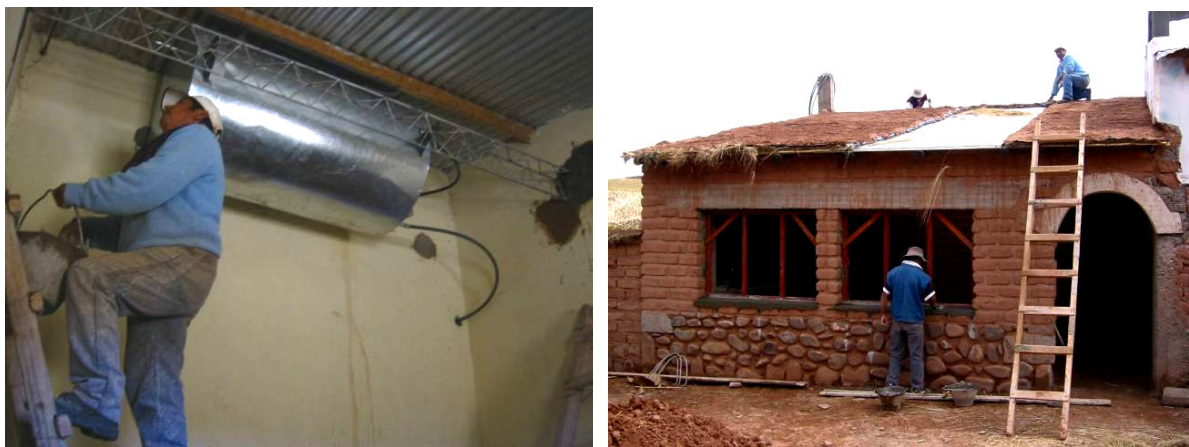
Abbildung 5: Warmwasserbehälter in Cusi Cusi und solares Gemeinschaftsbad in Cienaga
